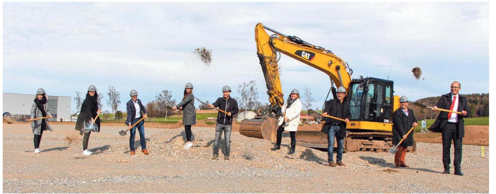
Beim symbolischen ersten Spatenstich (von links): die Gesellschafterinnen Martina und Sybille Maul, Wolfgang Kuhn, Danja Mayer und Fabian Pfau von Kuhn Bau, Alexandra Scherer, Raimund Haser, Berthold Leupolz und Roman Jungwirth. FOTOS: STEFFEN LANG
